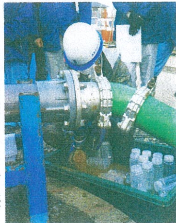
場内配管で夾雑物を確認
