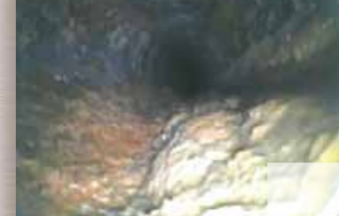
管径が断面縮小している
